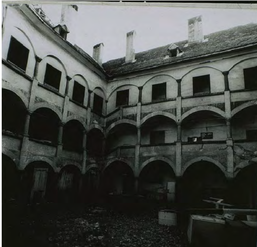
Abb. 5: Der Innenhof vor der letzten Sanierung (Quelle: Amt für Bau- und Kunstdenkmäler - Bozen)
